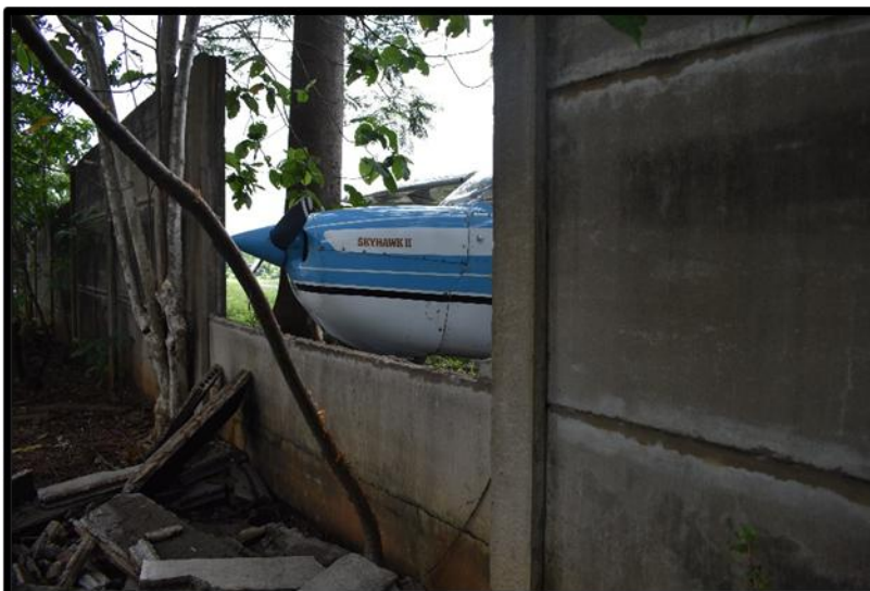
Fotografía No. 10 Daño provocado al muro prefabricado posterior al impacto.
